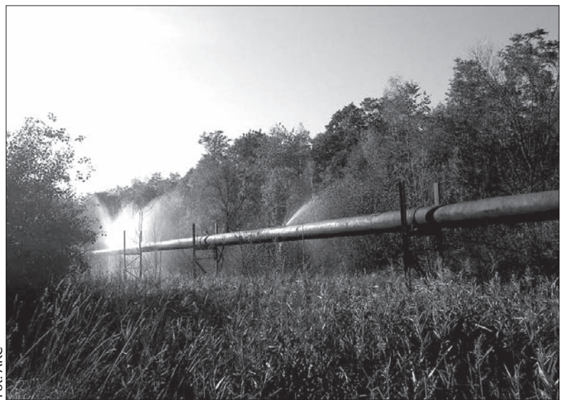
Wyciek spowodował w Stonawie obumarcie trzech wysokich drzew.
