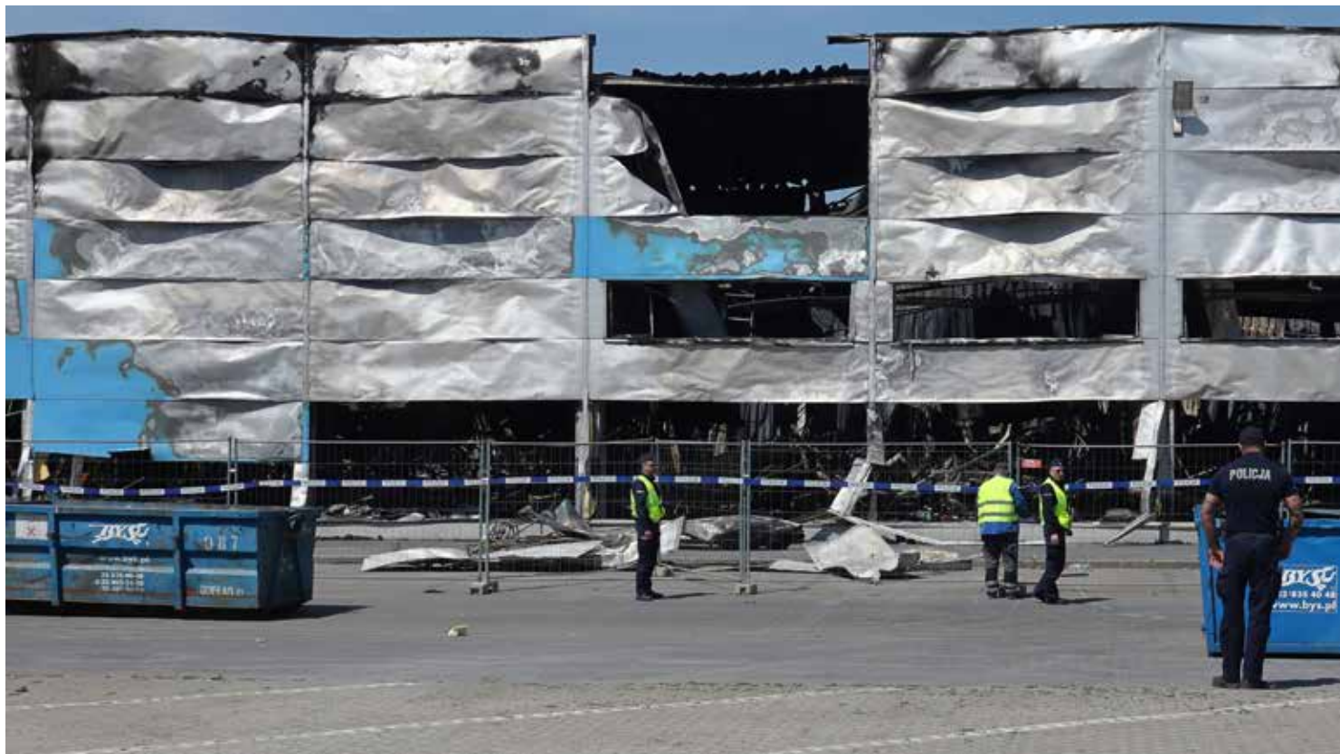
12 maja 2024 r. ok. godz. 3.15 w nocy wybuchł pożar, który strawił ogromne centrum handlowe Marywilska 44 w Warszawie. Pospowodowany podpaleniem obiektu przez grupę powiązaną z rosyjskimi służbami Fot. domena publiczna
