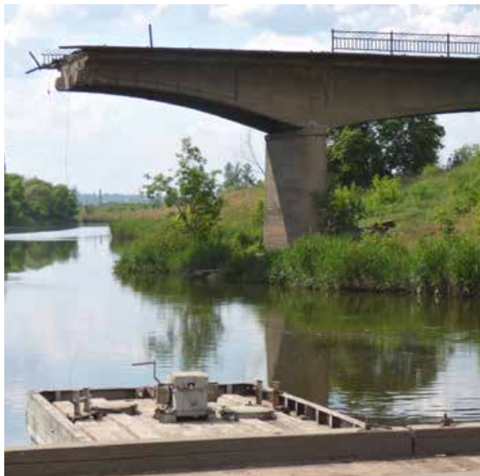
Zniszczony most pod Ługańskiem, 2019 r.
