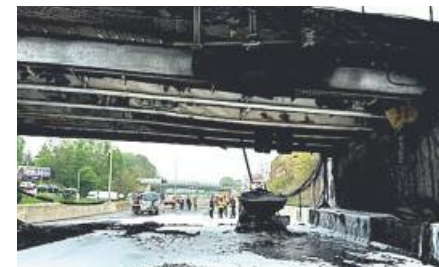
Wskutek pożaru poważnie został uszkodzony most na autostradzie I-95 w pobliżu Norwalk
