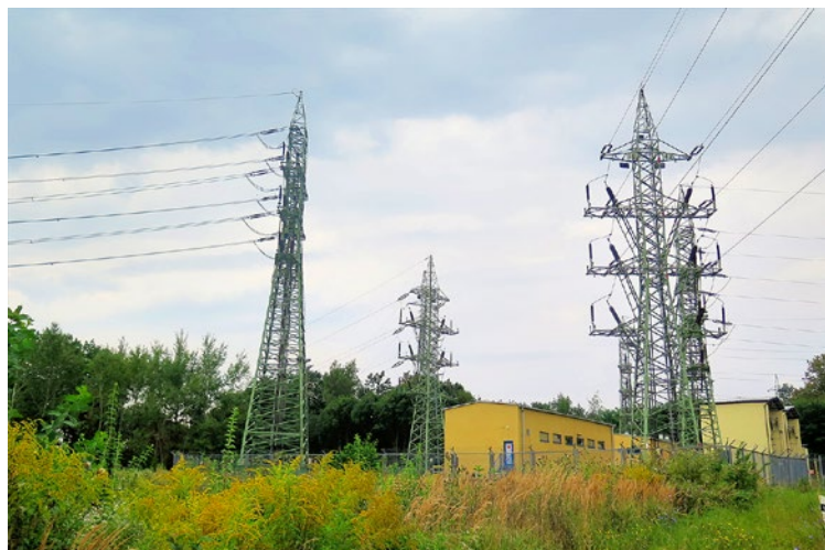
[ 5 ] Rozdzielnia prądu, w której zmienia się prąd wysokiego napięcia na niższe
