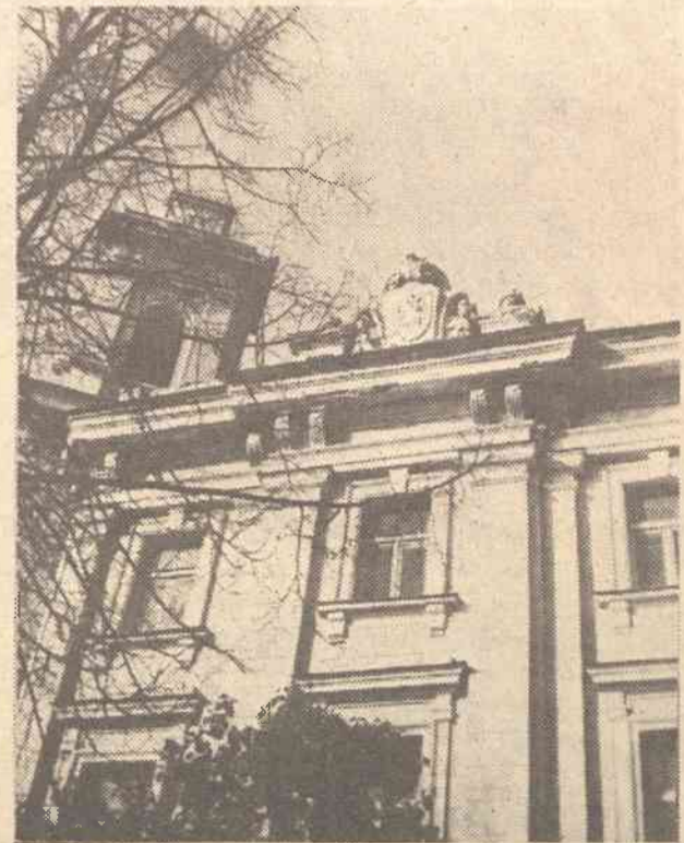
4. Ogołocona wieżyczka, powybijane szyby, opadający tynk, oto spadek naszych czasów. Na zdjęciu widzimy jeden z dwóch herbów Wilna.
