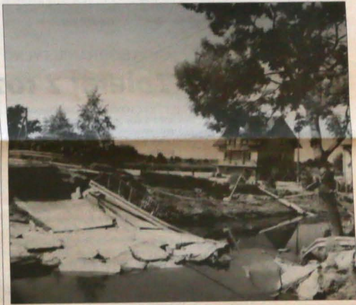
▲ W okolicach Zatoru widać jeszcze skutki straszliwej nawałnicy - porwany mosty, zniszczoną nawierzchnię dróg, popękane mury domów... Fot. MARTYNA RADŁOWSKA-OBRSNIK
