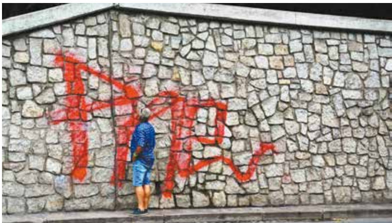
• Nieznanemu wandalowi „przeszkadzała” nowa ściana oporowa naprzeciwko dworca kolejowego w Trzynie. Jej budowę zakończono zaledwie pół roku temu. Sprawca spryskał powierzchnię wykonaną z granitowych kostek czerwoną i fioletową farbą. Usunięcie bazgrołów nie będzie łatwe. – Farba na ścianie oporowej wsiąkała w granitowe podłoże i dlatego musimy ją usunąć inną metodą niż tą, którą zwykle stosujemy w przypadku powierzchni betonowych. Musielibyśmy zamówić specjalny środek, ponieważ ten, którym usuwamy graffiti, tutaj by nie działał – powiedział Radomir Vlk, kierownik frydeckimiejskiego oddziału Zarządu Dróg Województwa Morawsko-Śląskiego. (dc) Fot. Magiśtat Trzyńca
