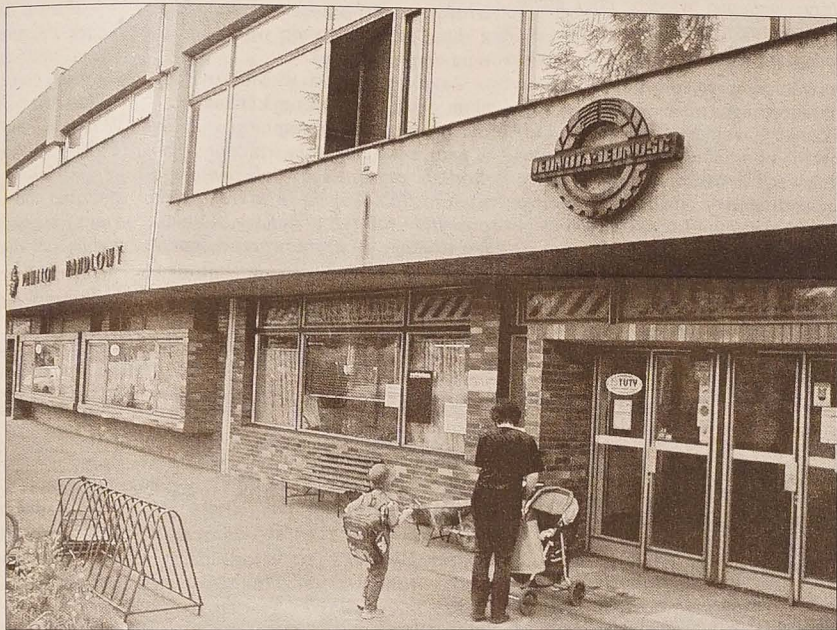
Jeden ze sklepów spożywczych „Jednoty-Jedności” zajmuje parter pawilonu handlowego w Olbrachcicach. Dach tego obiektu, który na początku lat 80. zbudowała w czynie społecznym miejscowa ludność, wymaga remontu.
