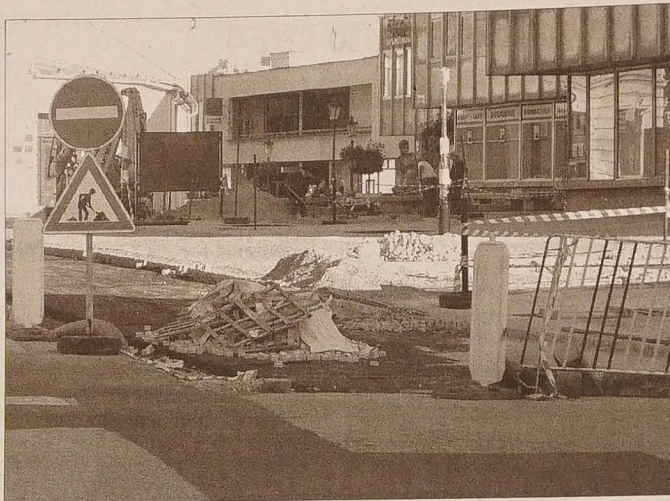
Rekonstrukcja ulicy Zamkowej w Karwinie Frysztaście obejmuje też budowę parkingu i przywrócenie na jezdniach i chodnikach dawno bruku. Prace prowadzone są przy częściowym ograniczeniu ruchu w pobliżu targowiska.
