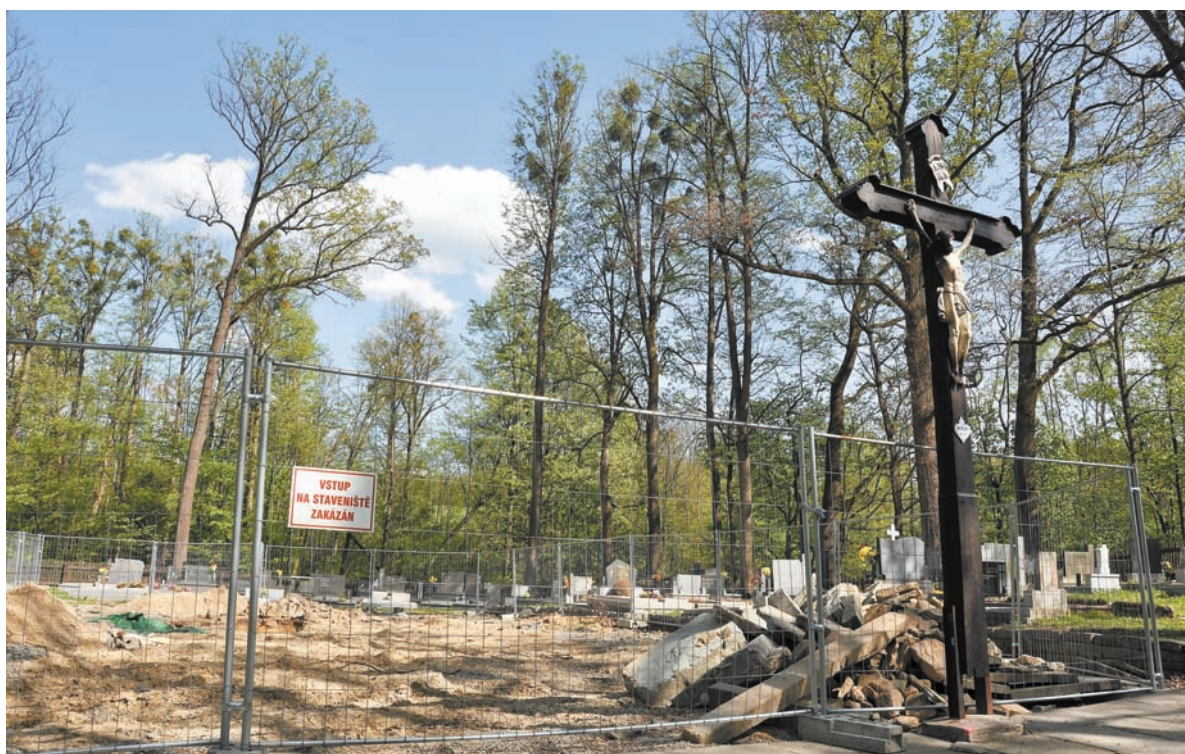
• Plac budowy został uporządkowany. Na początku przyszłego roku może ruszyć budowa. Fot. BEATA SCHÖNWALD
