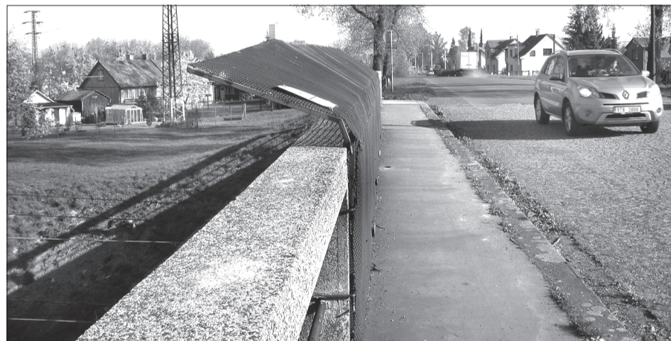
Wiadukt nad torami w Suchej Górnej pilnie wymaga remontu. Gmina będzie musiała zapłacić Zarządowi Kolejowych Dróg Transportowych kilka milionów koron za ograniczenia w ruchu.
