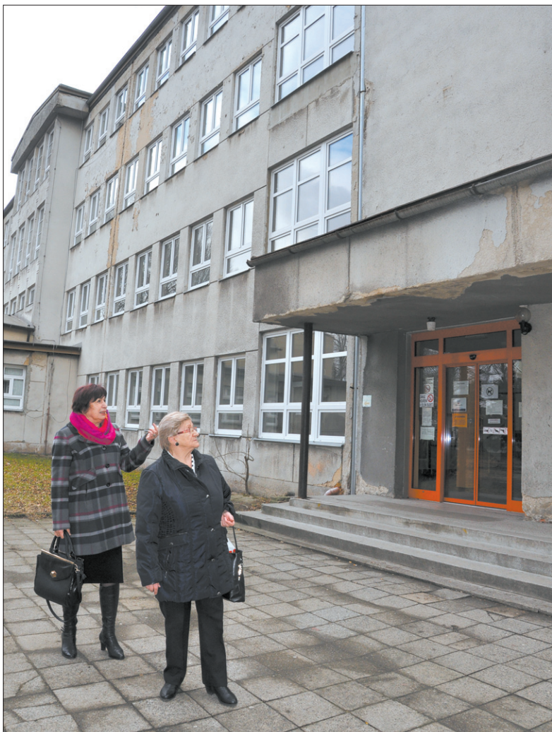
Budynek dawnej polskiej szkoły w Nowym Mieście wymaga remontu - uważają byłe dyrektorki.
