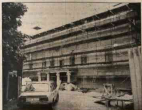
▲ Deszczowa pogoda nie sprzyja pracom sztukatorskim i tynkarzom na elewacjach fryzjackiego zamku, mającym przetrwać im pierwotny empyriowy wygląd. Trwają prace wewnętrzne zamku. Pracują murarze, tynkarze, elektrycy, hydraulicy i in. Uzupełniane są drewniane obudowy okien. Restaurowane będą koleje, pierwotne malowidła z 18. wieku. W maju przyszłego roku otwarta zostanie pierwszy część obiektu, w którym obok galerii, restauracji (na parterze) i winiarni (w suterrenach) na pierwszym piętrze znajdzie się sala ślubów (planowane są w niej również koncerty kameralne) i sala ekspozycji muzealna. (a) Fot. "SL" - M. RADŁOWSKA-OBRSUNIK
