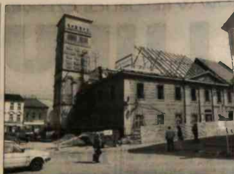
▲ Trwa rekonstrukcja starego ratusza w Karwinie-Fryztaście, której inwestorem jest miasto Karwinie. Zakonieczony budynek zaplanowano na listopad 1996 roku. Dostawcą prac remontowych jest firma "Zinstav" Zin. Fot. "GL" - TOMASZ ZWIYRTEK
