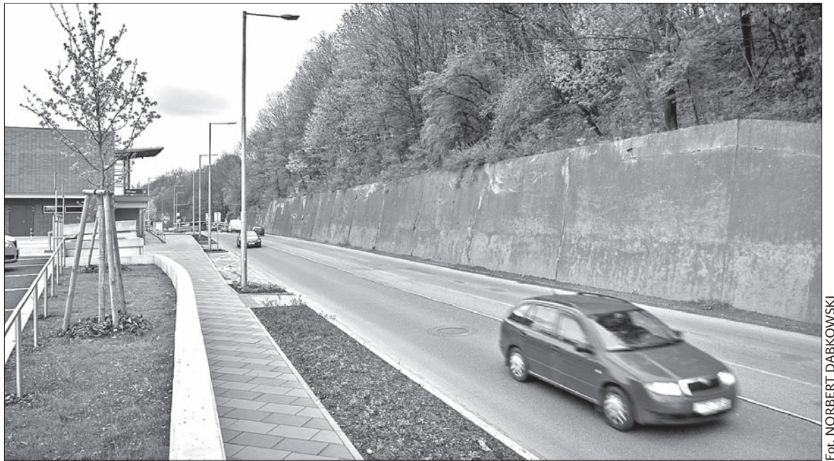
Szpecący mur doczeka się remontu.
