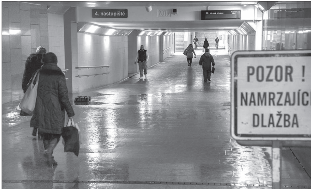
Woda zalewa przejście podziemne przy czeskokocieszyńskim dworcu kolejowym od zawsze.
