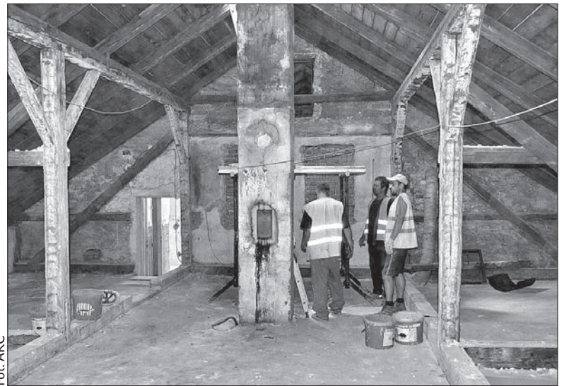
Włodarze Gródka postanowili wykorzystać wakacyjne miesiące i zająć się budową nowego Centrum Wolnego Czasu. Powstanie ono w nowym budynku przedszkola. Żeby mieszkańcy mieli gdzie spędzać wolny czas, by organizacje lub osoby prywatne miały gdzie urządzić spotkanie lub imprezę, włodarze gminy postanowili, że zagospodarują niewykorzystane poddasze obiektu. Inwestycja zostanie dofinansowana z pieniędzy Unii Europejskiej. (kor)
