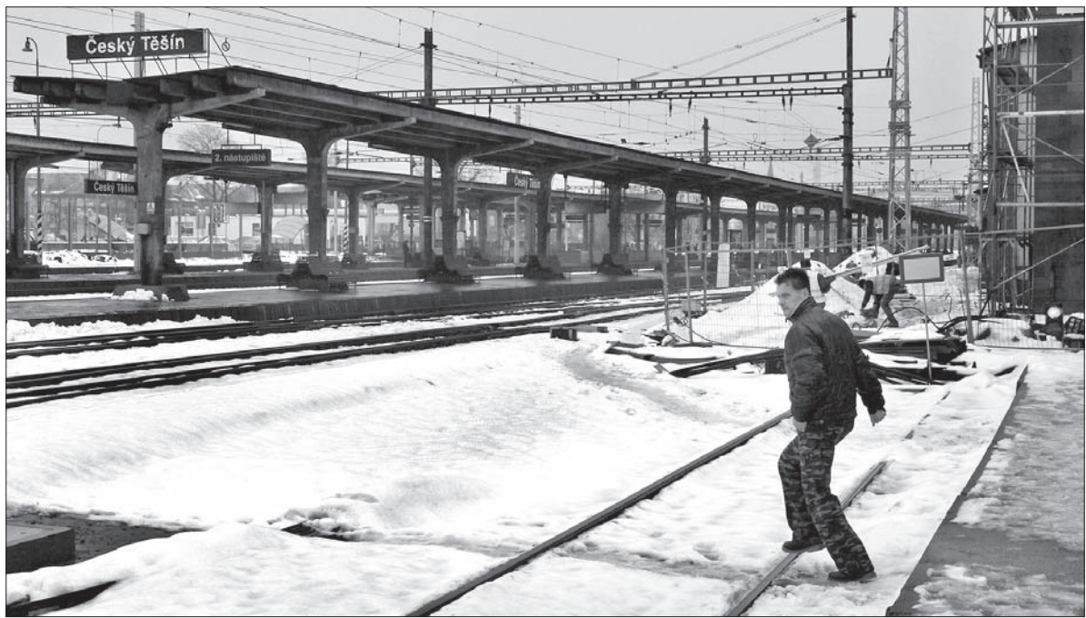
W najbliższych miesiącach w Czeskim Cieszynie częściej będzie trzeba przechodzić przez tory. 28 lutego ma ruszyć remont przejścia podziemnego pod torowiskiem.
