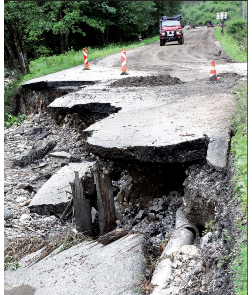
Kamienna lawina spadała z ogromną siłą, w kilku miejscach całkowicie rozbiła jezdnię na odcinku kilkudziesięciu metrów. W korycie rzeki leżą całe płyty asfaltu.
