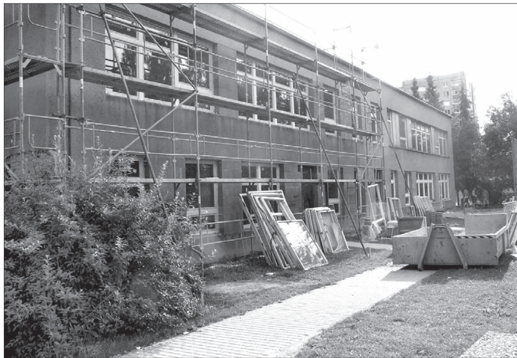
Prace remontowe w budynku polskiej szkoły i przedszkola w Sibicy trwać będą przez całe wakacje.
