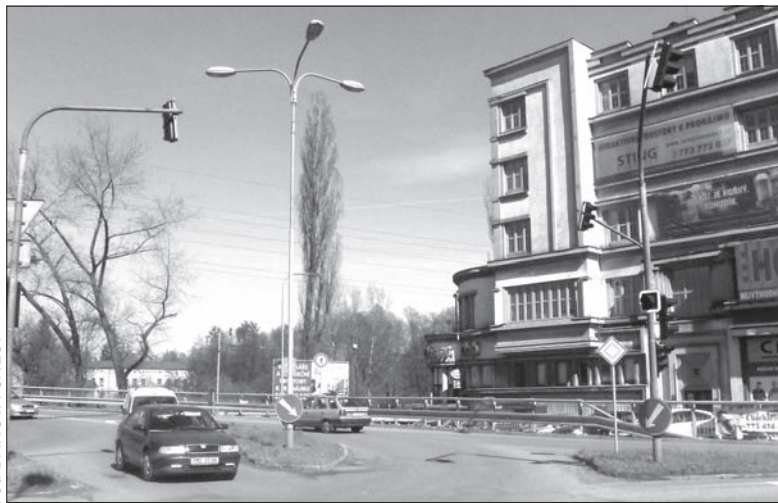
Na początku maja zostanie zamknięte dla ruchu skrzyżowanie, z którego prowadzi droga do głównej bramy huty.
