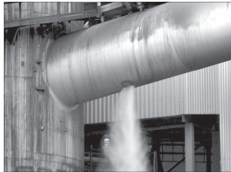
Pęknięta rura, z której ulatniał się gaz.
