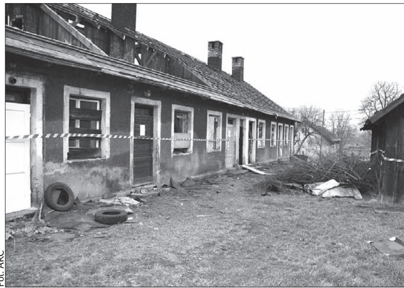
Zdewastowane domy na Folwarku znikną z powierzchni ziemi.
