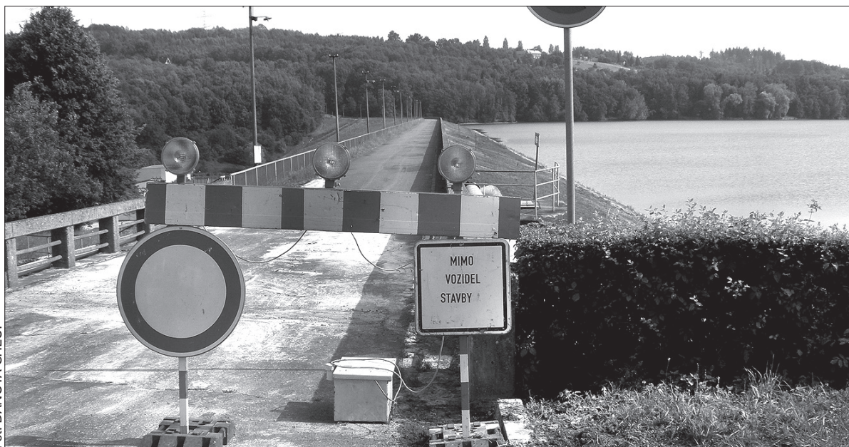
Droga przez koronę tamy między Olbrachciami a Cierlickiem jest od majowej powodzi zamknięta. Może tak być nawet przez dwa lata.
