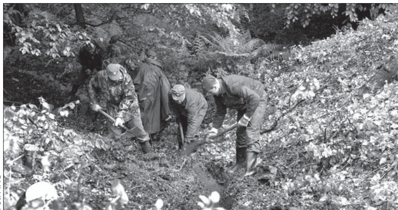
Wczoraj żołnierze kopali rów, którym może odciekać woda spod obsuniętej, podmytej drogi w Karwinie-Raju.
