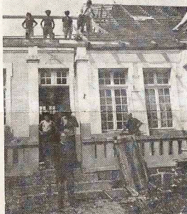
O antigo Colégio sendo demolido, depois de ter sido indenizado pelas autoridades responsáveis pelas obras da duplicação da Rodovia do Café.
