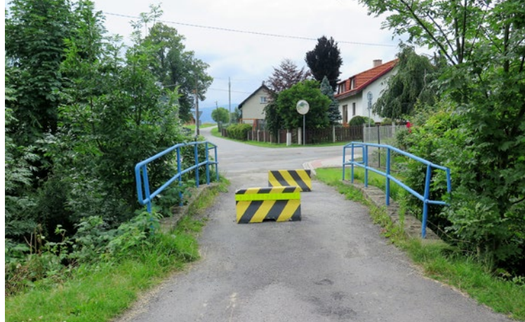
[ 13 ] Zamknięty dla ruchu samochodowego z powodu złego stanu mostek przez potok Kotelnica
