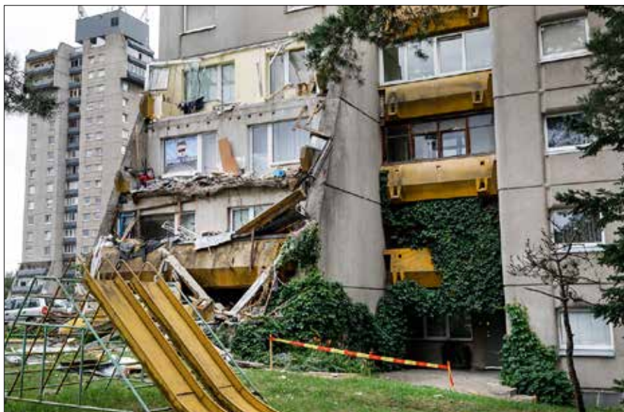
■ W 2020 r. w dzielnicy Lazdynai balkon runął z wysokości 15. piętra Fot. M. P.
