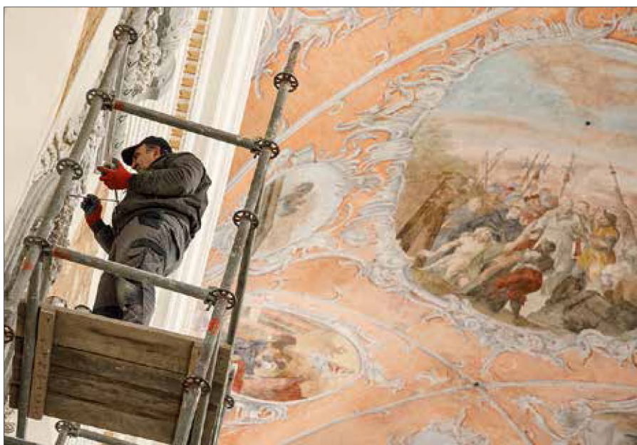
■ Prace renowacyjne były skomplikowane. Wymagały m.in. ustawienia w nawie i prezbiterium wysokiego, siedmiopoziomowego rusztowania
