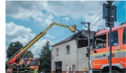
• Po ugaszeniu pożaru strażacy rozbierali dach. Fot. Straż Pożarna
