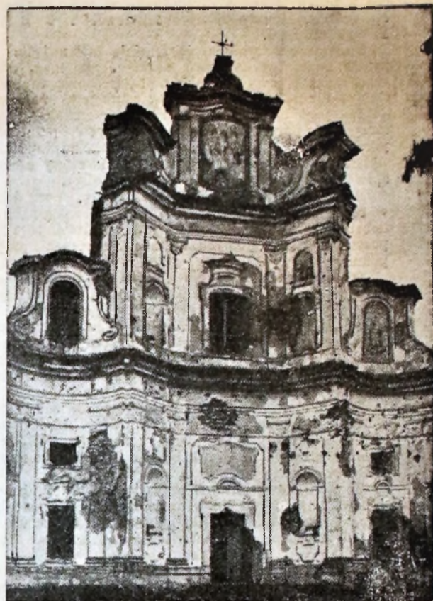
Ruiny kościoła poddominikańskiego w Czartorysku. Kościół ten, zbudowany przez wojewodę dorpackiego Jerzego Leszczyńskiego w r. 1639, w czasie wojny światowej został bardzo zniszczony. Obecnie jest on gruntownie odnawiany.
