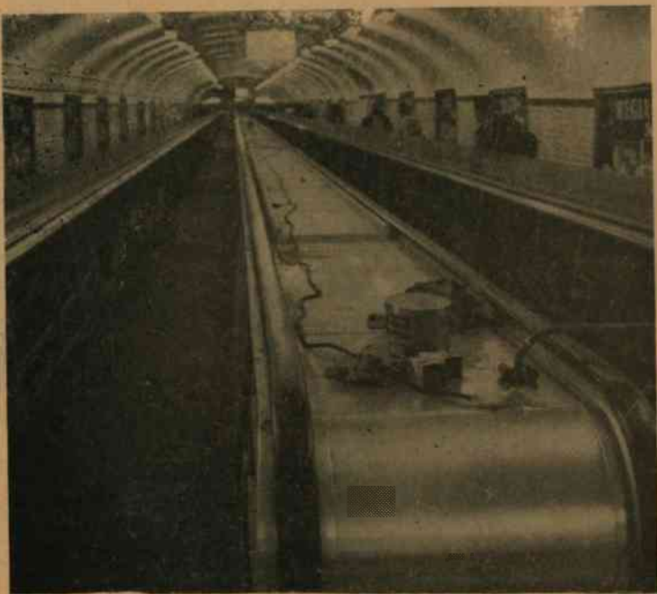
Nareszcie... podróżując w Paryżu metrem, a przesiadając na stacji Chatelet, nie będziemy zmuszeni chodzić nieskończenie korztażami. Zainstalowano bowiem chodnik mechaniczny długości 132 m. (nasze zdjęcie). Warto się nim... przejechać.
