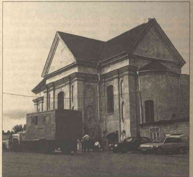
Tynk opada ze ścian, sypie się fundament, powybijane są okna
