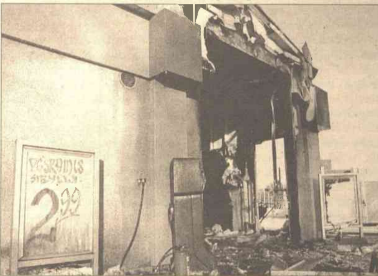
Ogień strawił 32 m 2 myjni oraz część dachu
