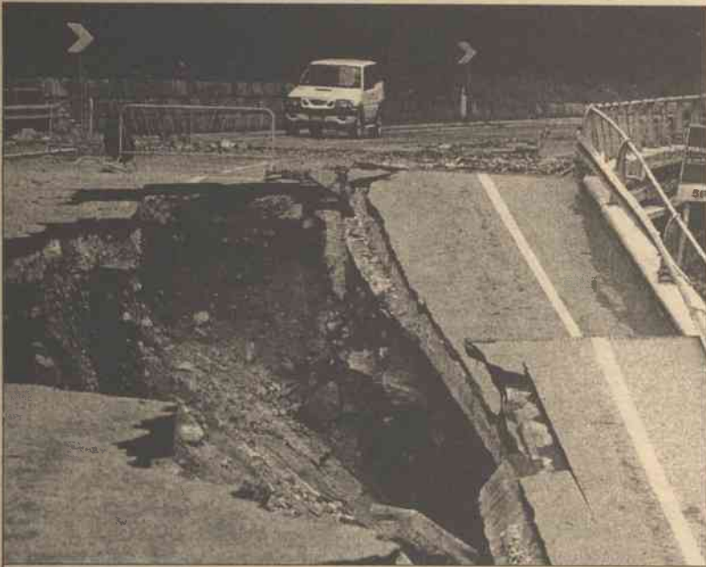
Podczas gdy na wysuszonym przez upały południu Włoch wciąż wybuchają pożary lasów, na północy lawiny błotne spowodowane przez gwałtowne nawalne i ulewy odcięły od świata wiele wsi i osiedli w Alpach Weneckich. Ewakuacja jest utrudniona, ponieważ muł i kamienie niesione przez potoki, które wystąpiły z brzegów, przerwały komunikację drogową. Fot. EPA-ELTA
