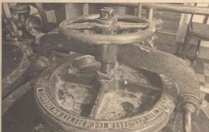
Do dziś służą jeszcze stare filtry firmy Mechanicznych Zakładów Bormann Szwede z Warszawy
