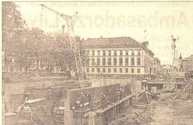
Budowa garaży podziemnych połączona jest z rekonstrukcją głównej alei stolicy — Giedymina. Zakończenie prac przewidziano na lipiec 2003 roku Fot. Marian Paluszkiwicz
