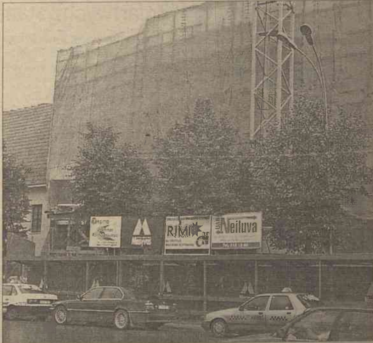
W powijkach dawne kino „Helios”, które się odrodzi z innym imieniem „RIMI” i innym przeznaczeniem
