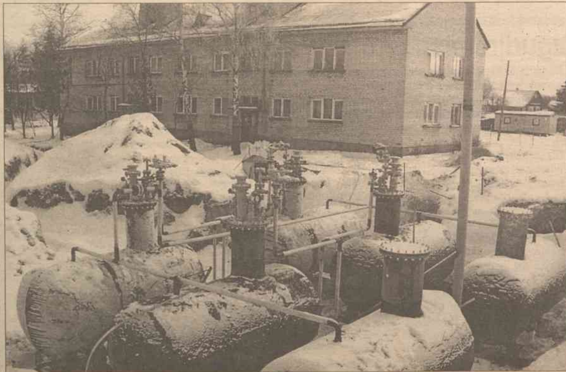
W kolejce nowy rodzaj paliwa do nowej kotłowni — gaz skroplony
