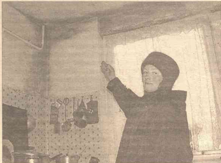
W niedogrzewanych mieszkaniach zapanowały wilgoć i pleśń
