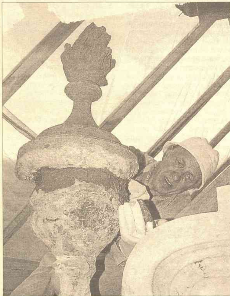
Wazy, niestety, trzeba będzie zdjąć z obiektu. Chwilowo, by potem w całej odnowie ustawić na te same miejsca. Ale najpierw trzeba na miejscu „załatać” dziury, by się nie rozsypały przy zdejmowaniu — mówi Jonas Butis
