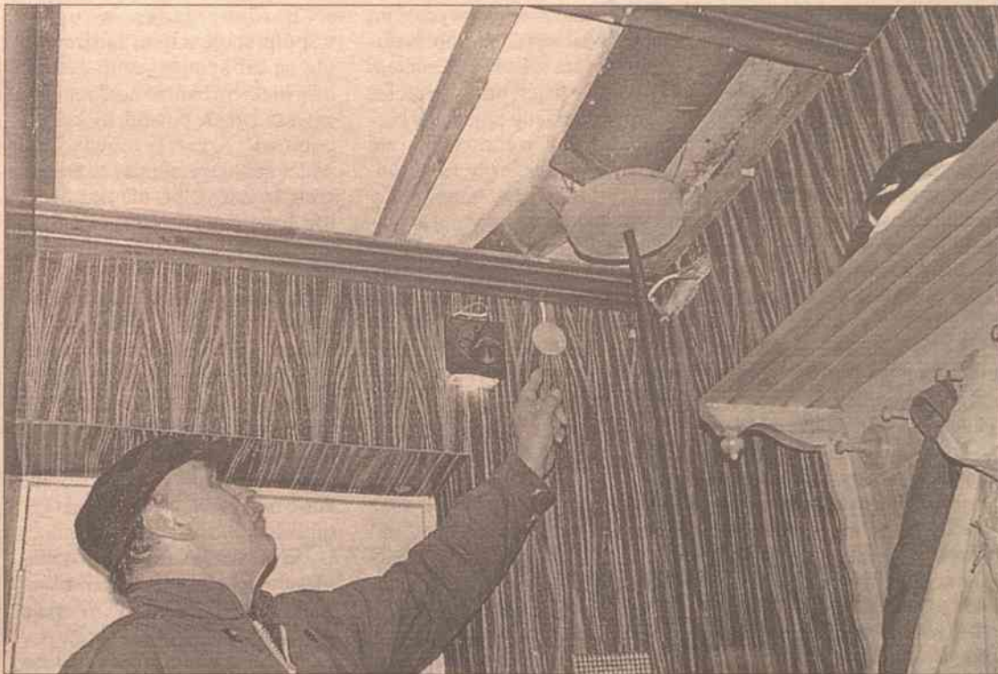
Przynajmniej podczas deszczu woda nie leje się na głowę - mówi Michalkiewicz demonstrując urządzenie odprowadzające deszczową wodę z sufitu do wiadra
