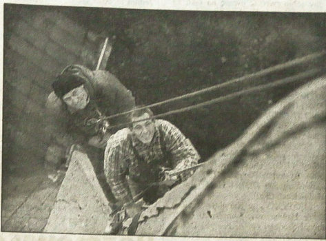
▲ Nie lada gratka trafiła się alpinistom Na Niwach w Czeskim Cieszynie - wymiana poszczy dachu 45-metrowej dzwonnicy kościoła miejscowego zboru Śląskiego Kościoła Ewangelickiego A.W. - Dziękuję nim karwiłanka firma KOMI mogła się obyć bez rusztowań i dźwigni.
