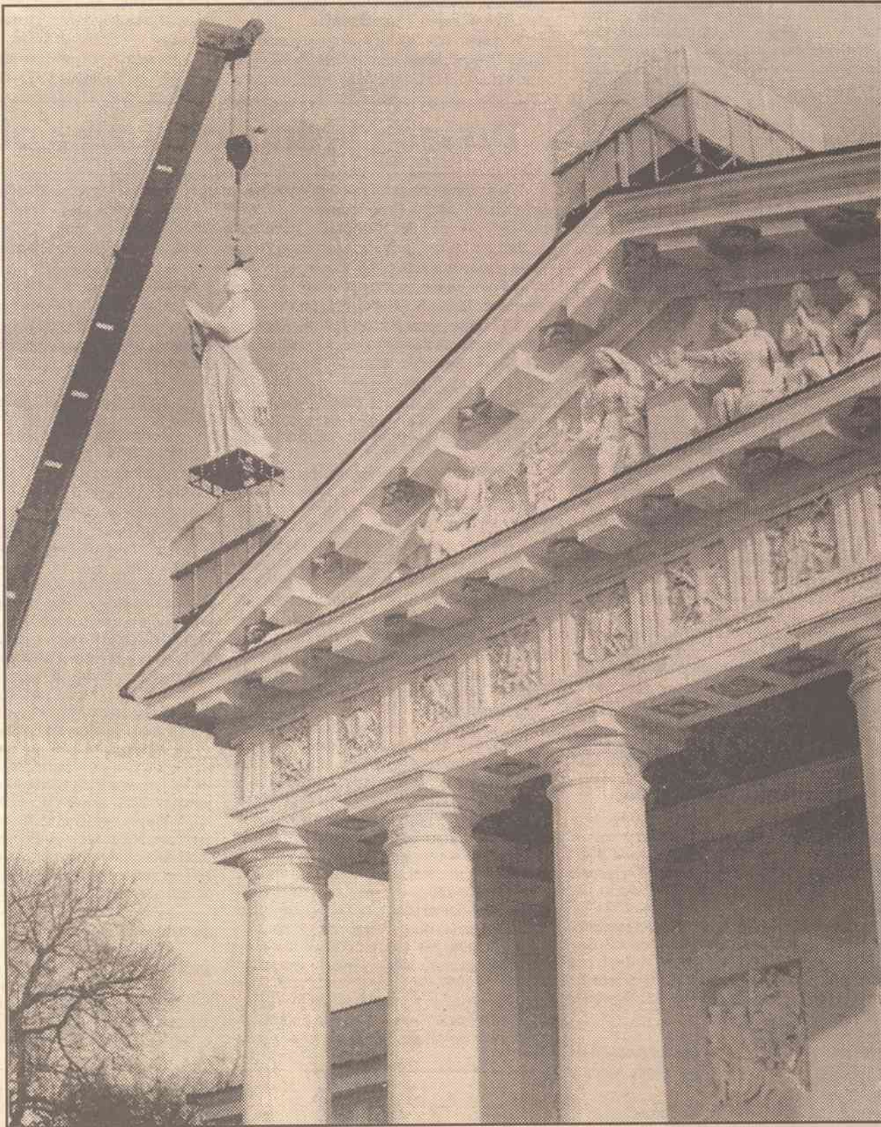
Rozpoczęły się prace nad ustawianiem rzeźb na frontonie Katedry Wileńskiej. Na Bazylikę już wrócił św. Stanisław, a także św. Helena, trzymająca w ręku krzyż. Do tego celu wykorzystano dźwig samochodowy o największej na Litwie mocy. W pracowni trwają jeszcze roboty przy św. Kazimierzu, który w grudniu również zajmie swoje miejsce na świątyni
