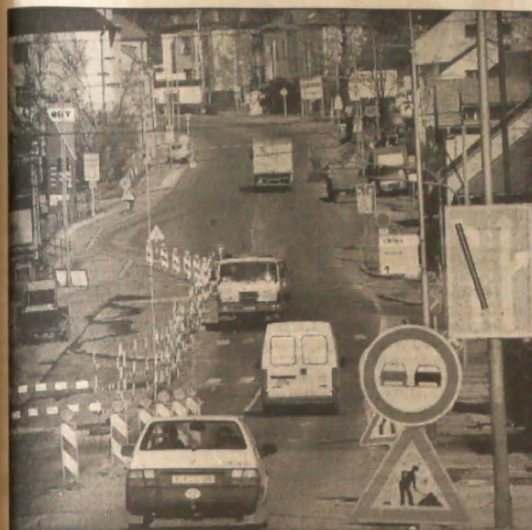
▲ Od paru tygodni trwa przebudowa skrzyżowania ulicy Cieszyńskiej z Frysztačką w Ostrawie-Radwanicach na bardziej bezpieczne o układzie dojazdowym w kształcie ronda. Fot. JOSEF TALAS
