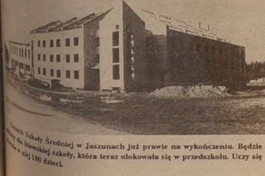
Widok na Jaszunachską Szkołę Średnią w Jaszunach Już prawie na wykończeniu. Będzie to jedna z największych szkół w rejonie. W tym roku ukończono już budowę przedszkola. Uczy się tu 180 dzieci.
