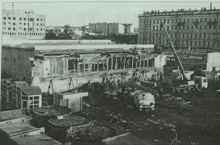
Siedem osób zginęło, a 11 przeżywa w szpitalu z powodu obrażeń, jakich doznały w czwartek na skutek zaważenia się betonowego dachu nad jedną ze stacji metra w Sankt Petersburgu. Wcześniej informowano o siedmiu rannych. Pięć osób zginęło na miejscu, a dwie zmarły w szpitalu. Świadkowie zaisciska utrzymują, że dzięki towarzyszący wypadkowi przypomniał wybuch bomby, lecz po wstępnych oględzinach miejsca zaisciska, ekipy śledcze wykluczyły atak terrorystyczny. Na razie nie wyjaśniono przyczyn zaważenia się betonowego dachu nad wejściem do stacji metra „Siennaja Ploszczadz”. Dach miał ok. 100 m kwadratowych. Stacja, wg miejscowych władz, zostanie zamknięta prawdopodobnie do końca czerwca.
