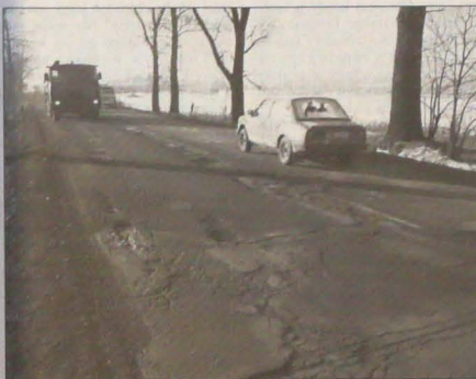
▲ W Nawisiu-Harcowie samochody z trudem omijają szereg pęknięć i dziur na nawierzchni jezdni. Fot. DANUTA BRANNA
