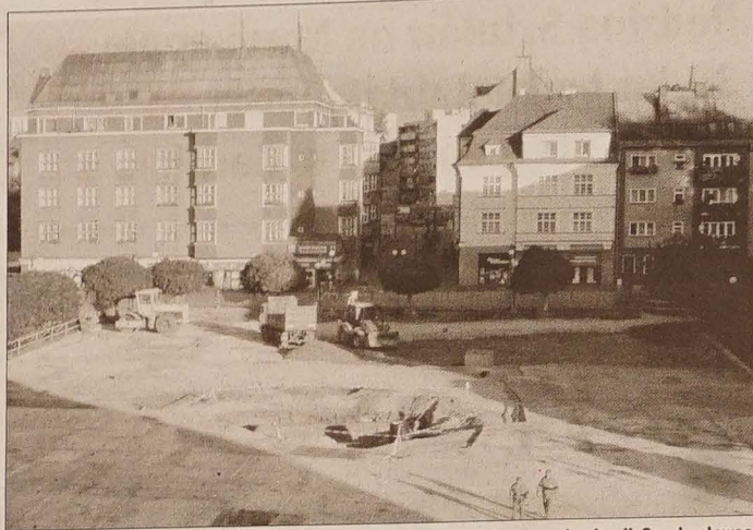
Już czwarty miesiąc trwa trzeci etap remontu czeskokoczyńskiego rynku Armii Czechosłowackiej. Rozpoczął się on w czerwcu, a jak poinformował „GL” wiceburmistrz Marian Kuś, firma TCHAS powinna go sfinalizować najpóźniej w listopadzie br. W ramach prac płyta rynku otrzyma nową nawierzchnię z kolorowych kostek brukowych i szarych pasów z granitu. Na środku rynku stanie fontanna zbudowana wg projektu Otomara Ševčíka, autora m.in. Fontanny Křížka w Pradze. Fot. JACEK SIKORA
