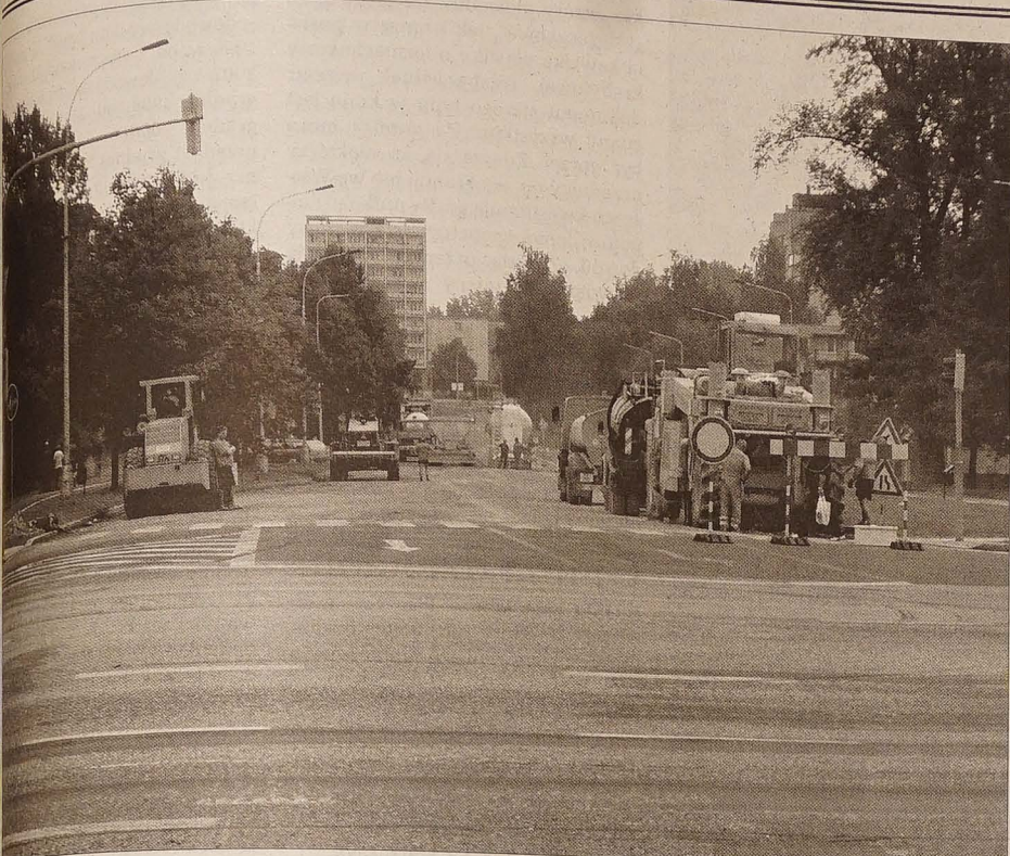
Prace drogowców to okres intensywnych prac drogowych. W Karwinie ostatnio wzięli się za nawierzchni i reperowanie poboczy odcinka ulicy Borovského – od skrzyżowania z ulicą Uniwersytetu Śląskiego po skrzyżowanie przy sklepie meblowym. Roboty przebiegają sprawnie, jest więc szansa, że w przyszłym tygodniu na odcinku tym przywrócono zostanie normalny ruch.
